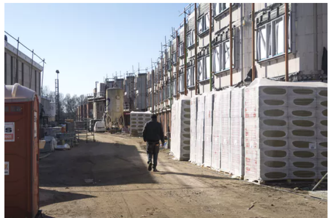
Het Deltakwartier, een nieuwe wijk aan de rand van Presikhaaf in Arnhem wordt ontwikkeld onder meer door woningcorporatie Portaal. Er komen zowel koophuizen als sociale woningbouw. Foto: Bert Spiertz/Hollandse Hoogte
